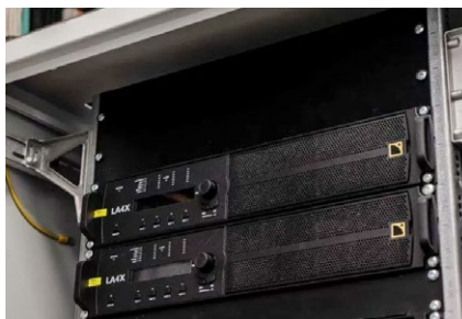
会場のL-Acoustics LA4Xアンプリファイド・コントローラー。
