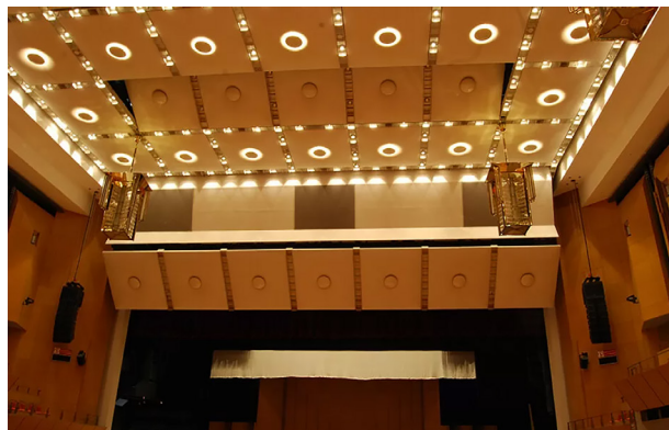
モーツァルトホールのプロセニアムスピーカー（センターは埋込）今回の改修でL-Rが露出になりました
