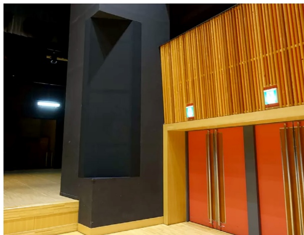
サランネットの奥にKivallとSB15mを設置
