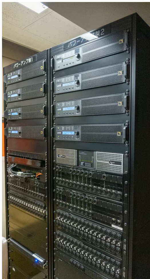
常設システムはLA4X × 8台で駆動 左のラック下にブランクパネルが多く見られる
